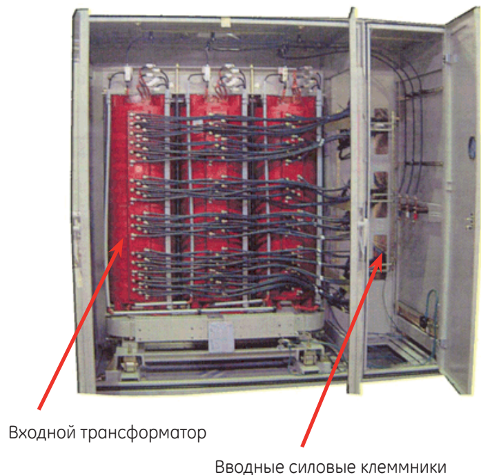
Привод SB - 57 - 710 кВт, 6,6 кВ
